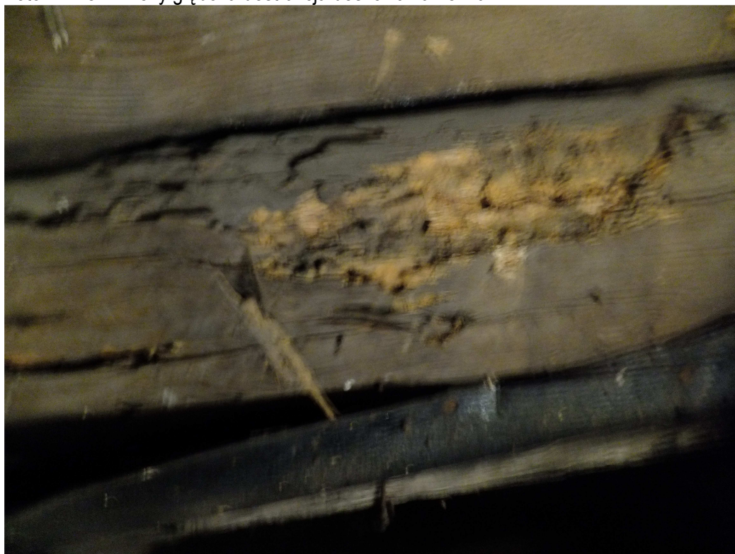
Foto 7 Hełm wieży głęboka destrukcja deskowania hełmu
