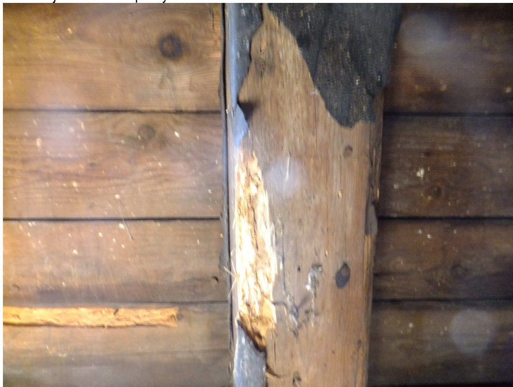
Foto 6 Hełm wieży Destrukcja krokwi oraz poszycia deskowania hełmu
