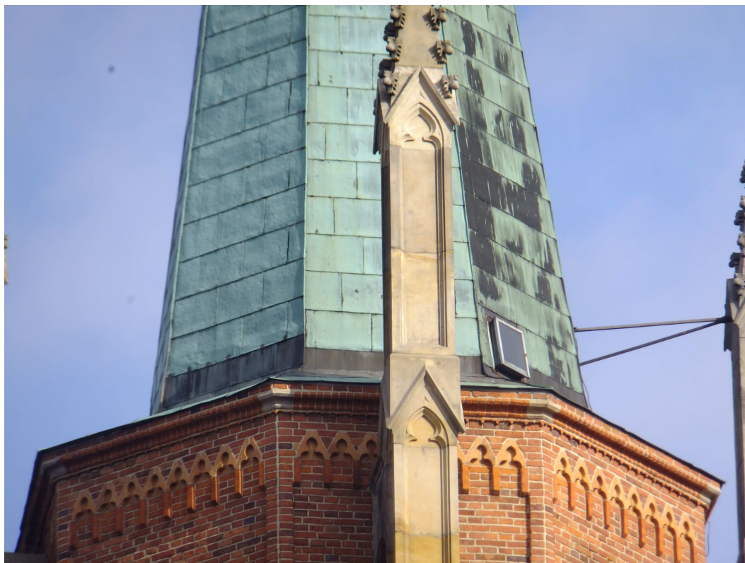
Foto 5 Destrukcja poszycia w części dolnej.
