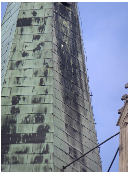
Foto. 4 Destrukcja poszycia w części centralnej hełmu
