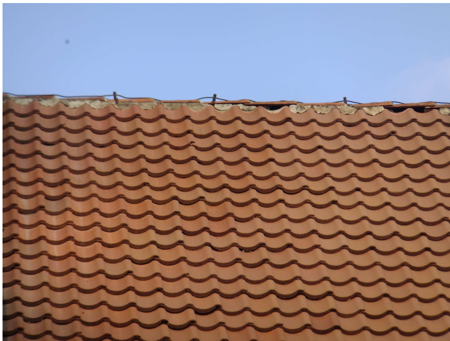
Foto 3 Uszkodzenie pokrycia w kalenicy nad nawami kościoła, (braki kształtek, uszkodzona instalacja odgromowa) .
