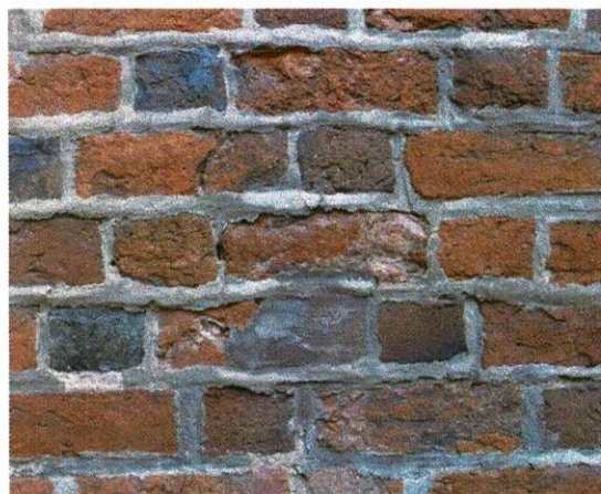
Odspajające się wtórne spoiny.
