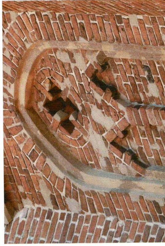
Strona południowa. Tynki na uskokowych glifach blend. Ubytki cegieł uzupełniane cementem.
