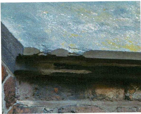
Mechaniczne uszkodzenia daszków.
