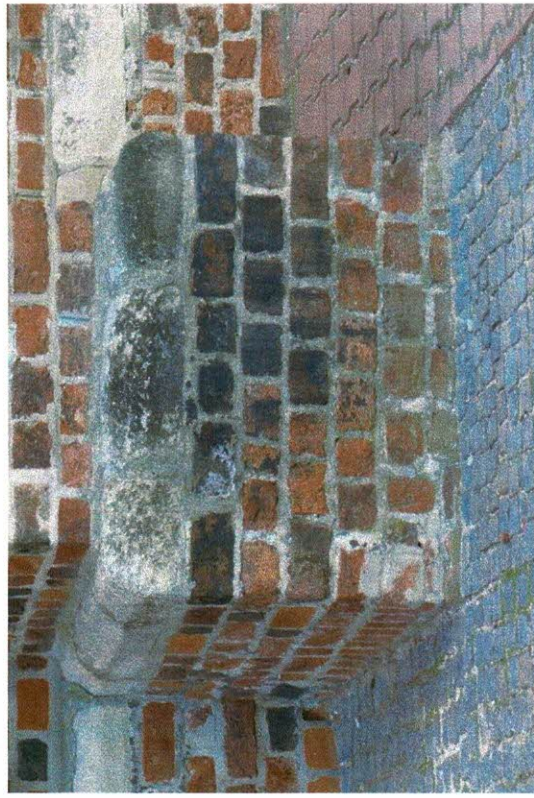
Cokół. Zabrudzenia cegieł i kamienia.
