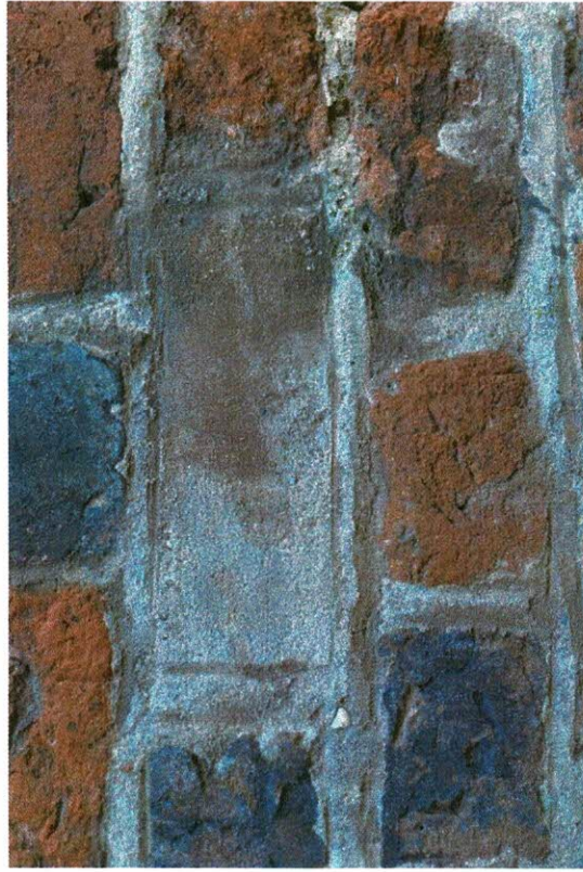
Ubytki cegieł uzupełnione cementem. Cementowe spoiny.
