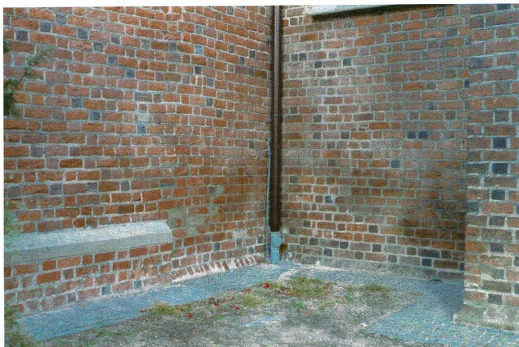
Ciemniejsze strefy zawilgoconych ścian.
