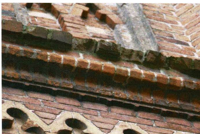
Ubytki kształtek gzymsu.
