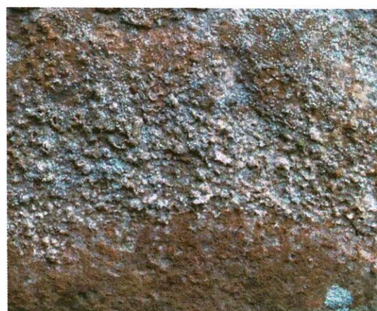
Wykwity soli na cegle.
