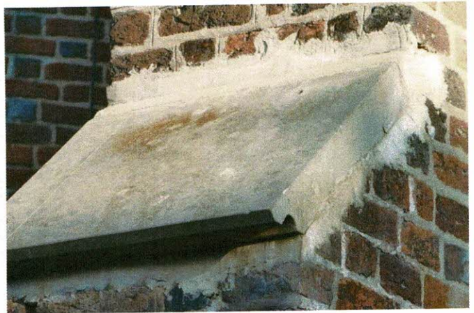
Nieestetyczne obmurowanie nakrywy.
