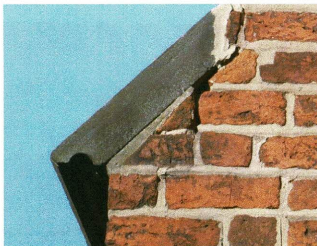
Pęknięcia muru i odspajanie daszka.
