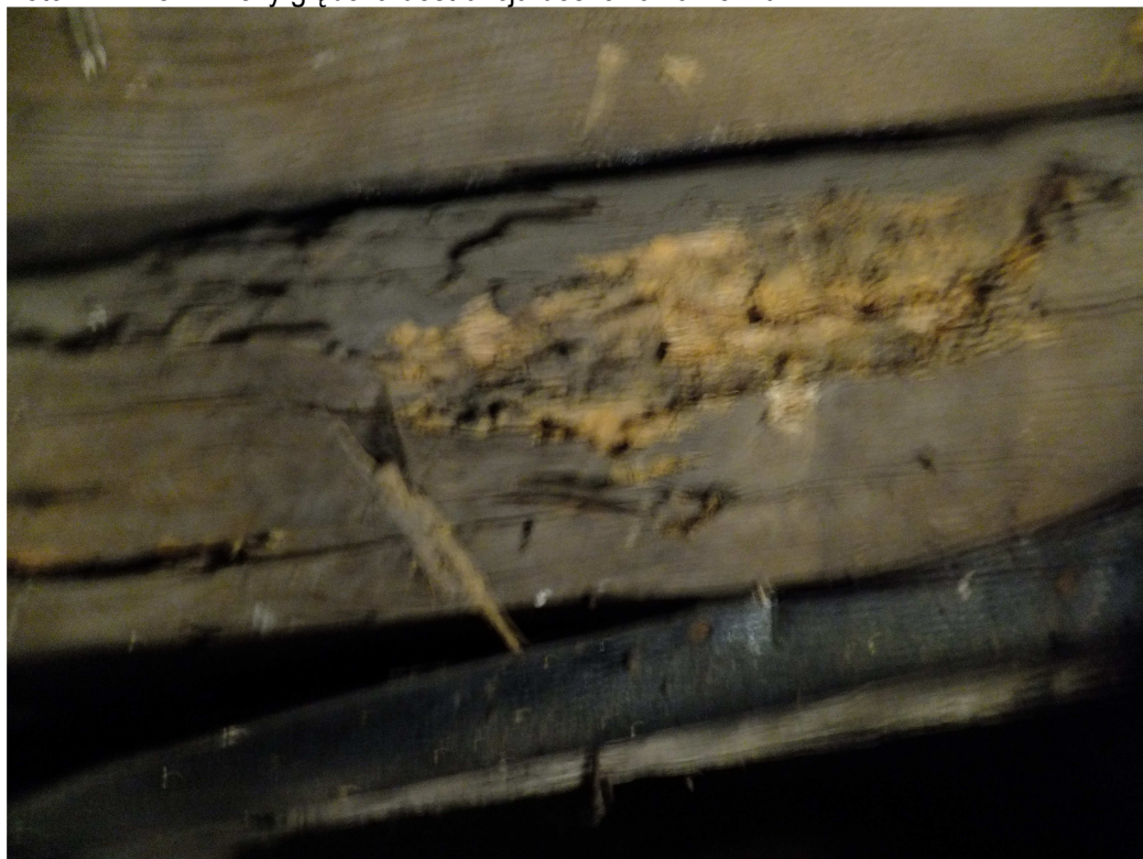
Foto 14 Hełm wieży głęboka destrukcja deskowania hełmu
