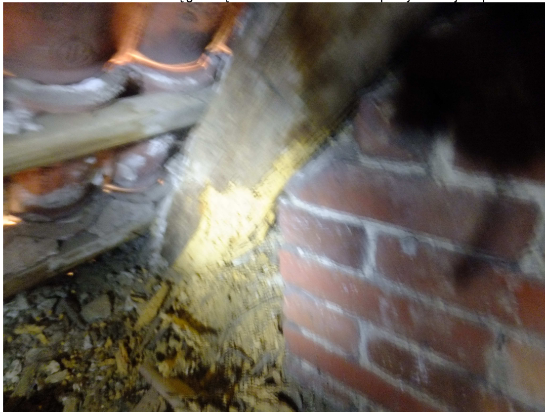
Foto 10 Poddasze nad nawą główną widoczne nieszczelności pokrycia miejsc przecieków i ich skutki
