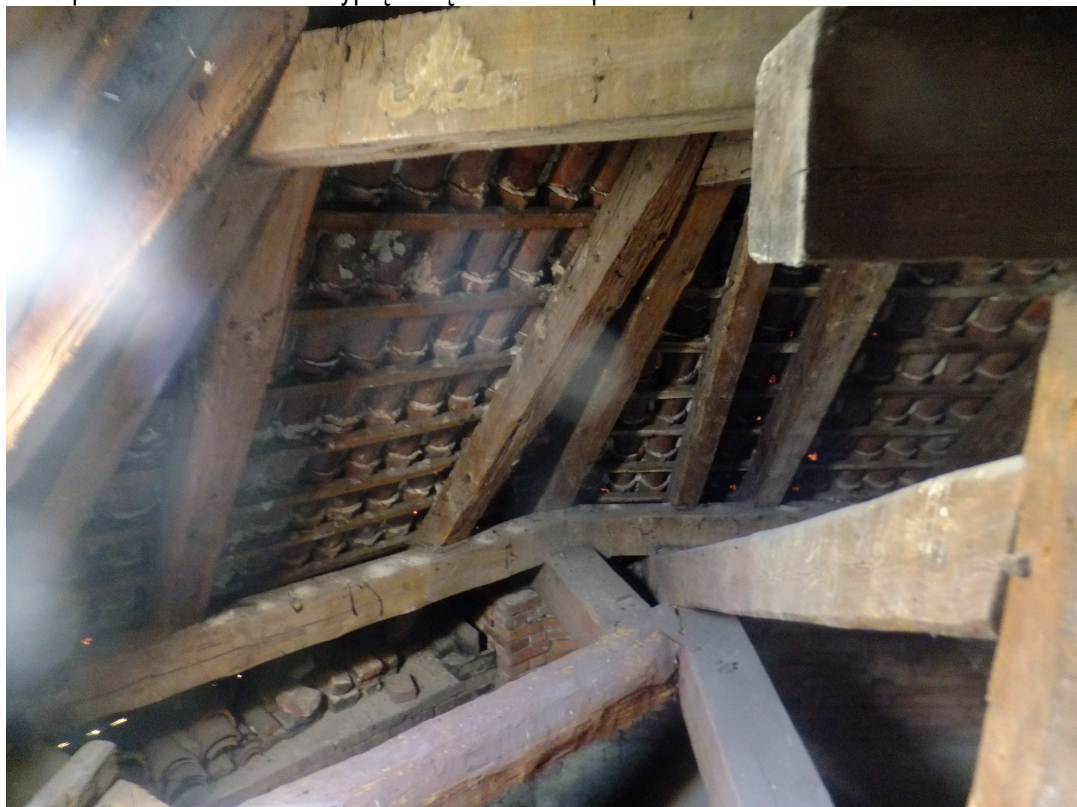
Foto 11 Poddasze nad prezbiterium widoczne miejscowe uszkodzenia powierzchniowe Białe plamki na murlacie to sypiąca się z dachu zaprawa
