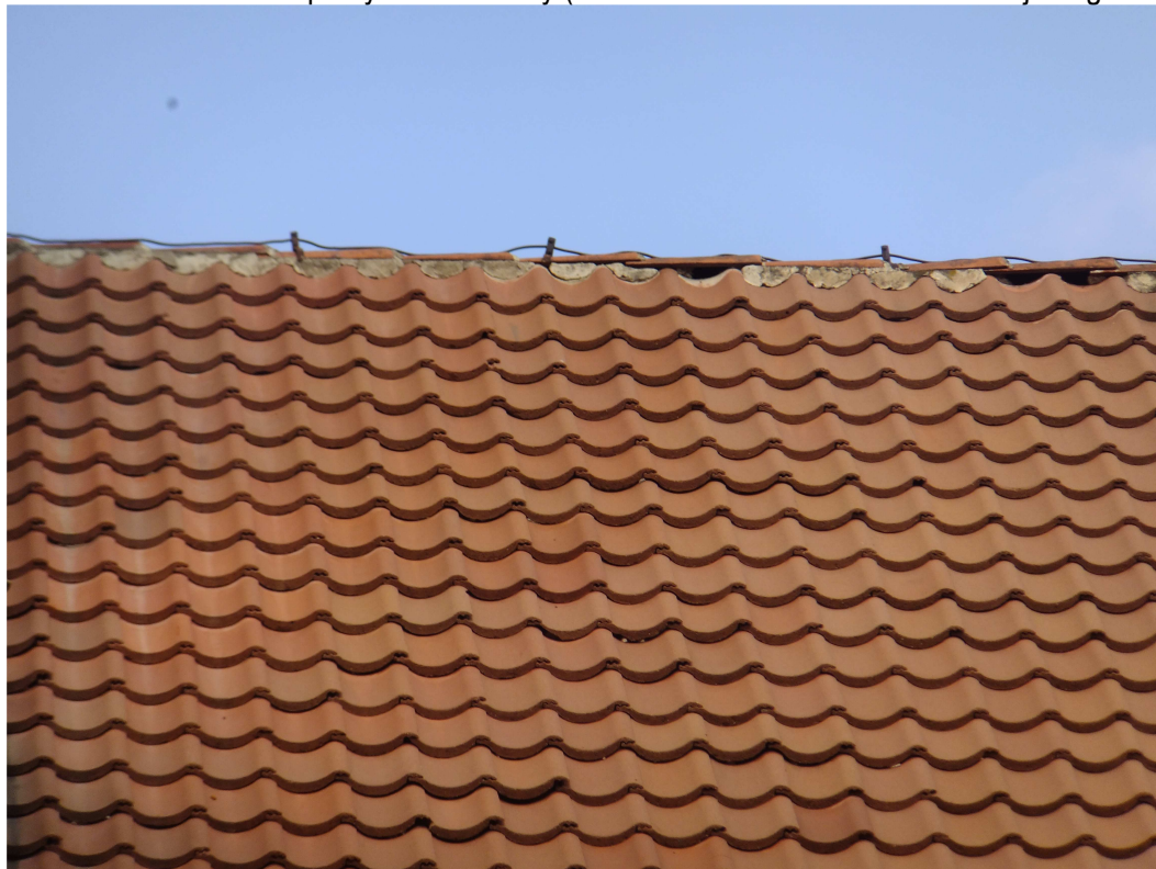
Foto 6 Uszkodzenie pokrycia w kalenicy (braki kształtek uszkodzona instalacja odgromowa)
