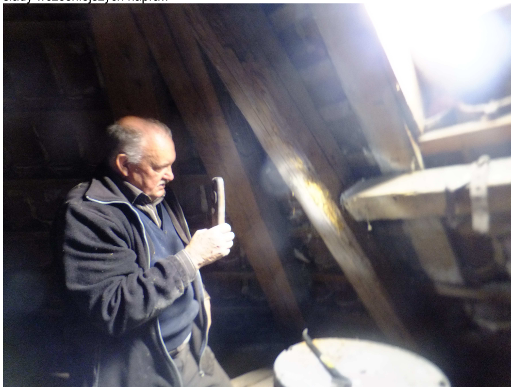
Foto 12 Poddasze nad prezbiterium. Widoczna powierzchniowa destrukcja elementów więźby oraz ślady wcześniejszych napraw
