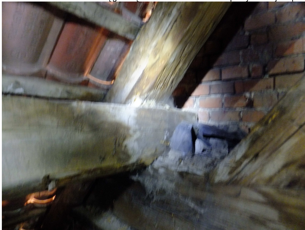
Foto 9 Poddasze nad nawą główną widoczne nieszczelności pokrycia miejsce przecieków i ich skutki
