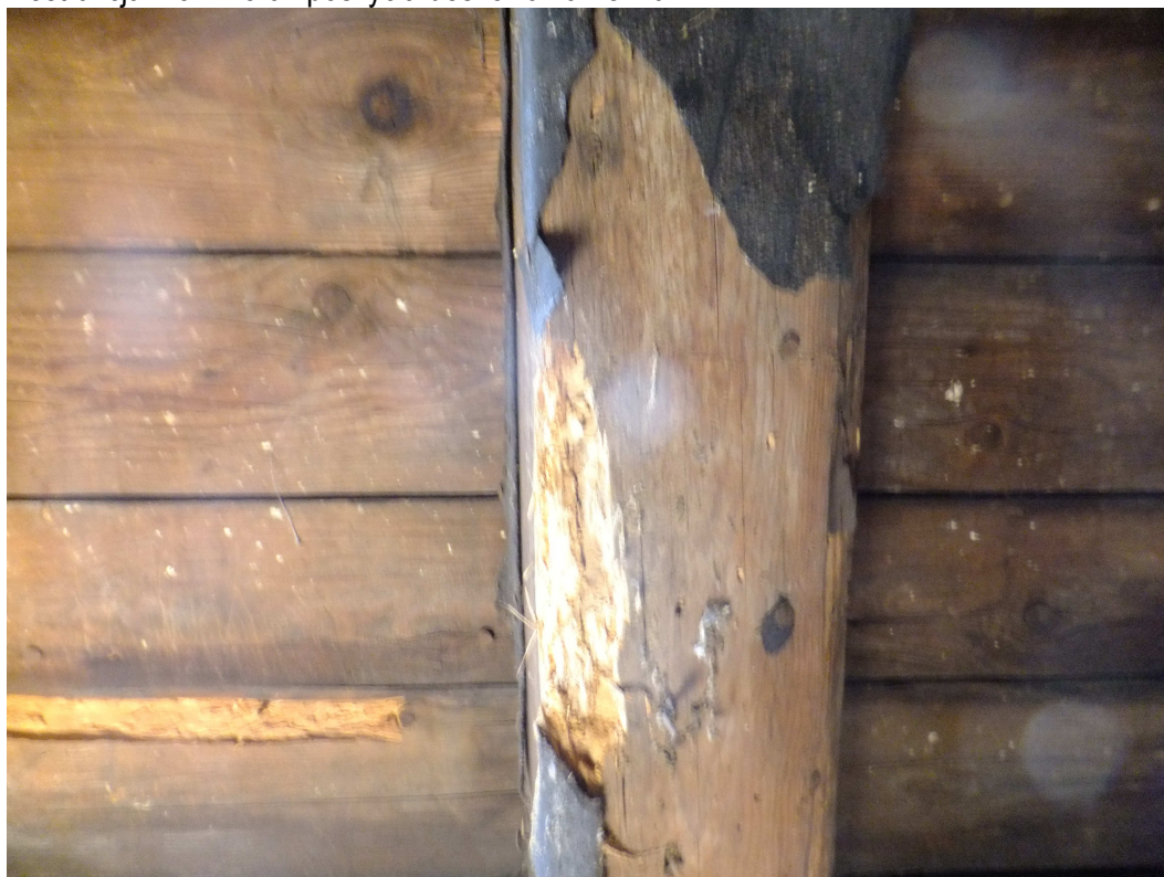
Foto 13 Hełm wieży Destrukcja krokwi oraz poszycia deskowania hełmu
